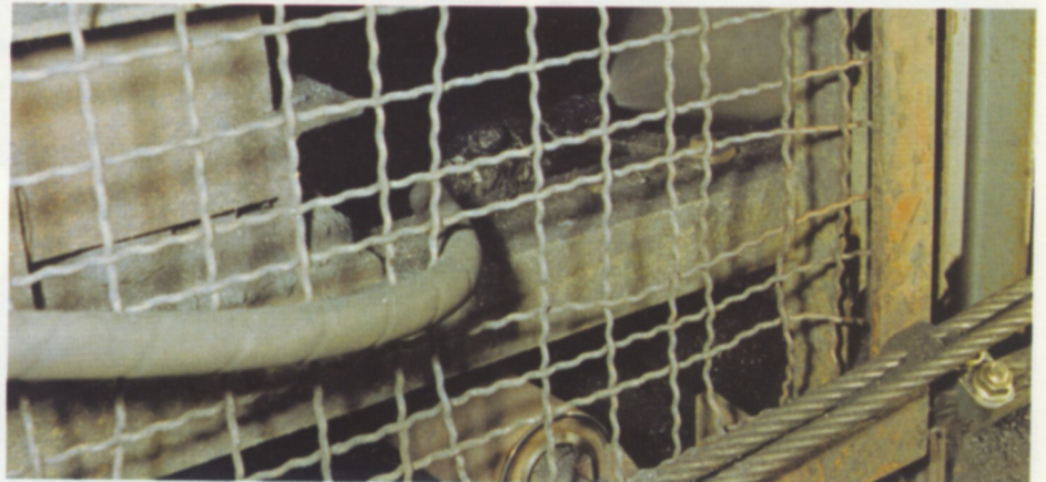
Bedüsung im Bereich einer Gurtbandumkehre
