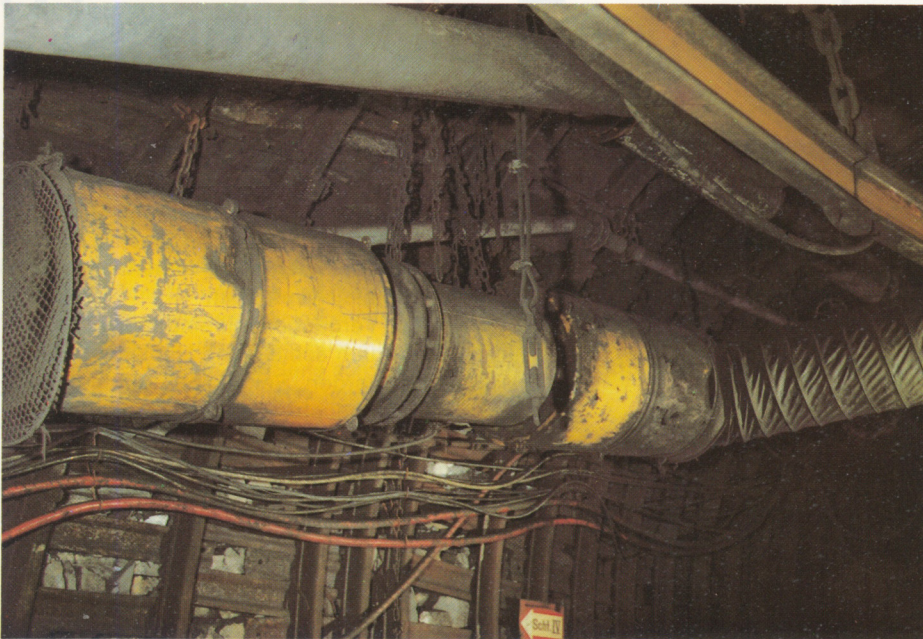
Sonderbewerterlüfter mit paarweise eingebauten Schalldämpfern
