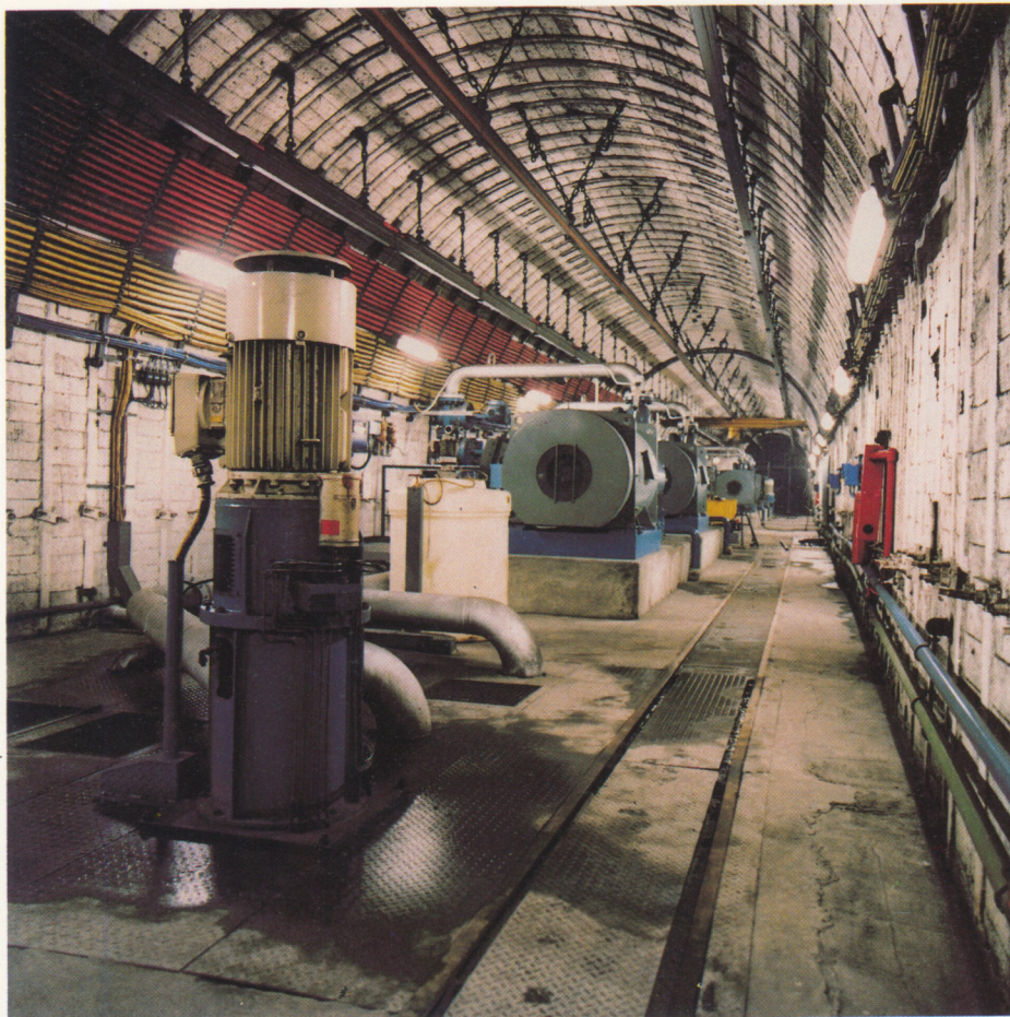
Pumpenkammer mit Zubringer- und Hauptpumpen
