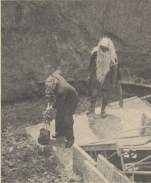
Am 23. 6. 1954 beginnt das Abteufen des Schachtes 5 mit dem ersten Spatenstich, ausgeführt vom Vorsitzenden des Aufsichtsrates, J. M. Fentener van Vlissingen.
