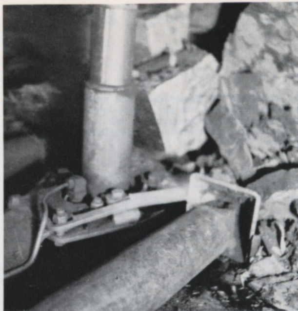
Der sogen. Köcher: Er dient in Streben mit hydraulischen Ausbaugestellen als versatzseitiges Widerlager für die Rückzyylinder.
